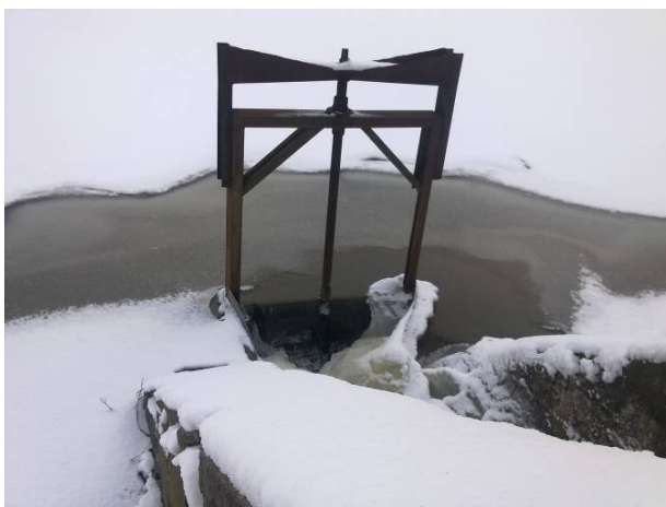
Рис. 23. Закрытый водовод, проложенный от левого берега Нижнего паркового пруда
