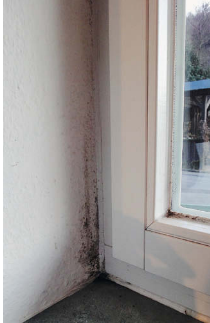
Schadensbild: Raumecke zur Außenwand.
